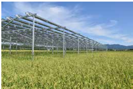
写真:水田におけるソーラーシェアリングの例 (出所:井川町営農型太陽光発電設備初号機[秋田県南秋田郡井川町]筆者撮影)
