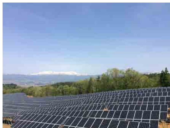
写真 3：雄国太陽光発電所（会津電力）
